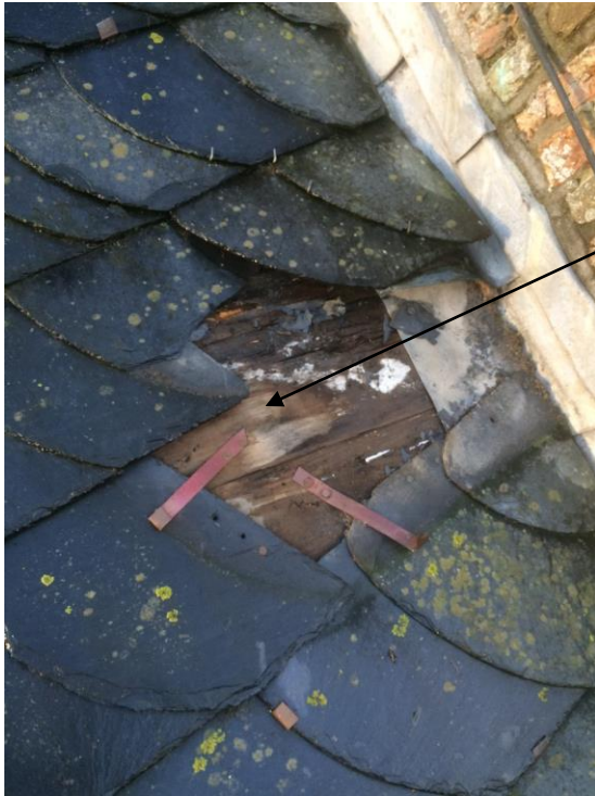
Rotte plekken en schimmels tegen de westelijke kopgevel.
